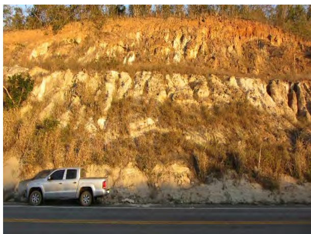
Figura 116. Sulcos erosivos em talude de corte efetuado para construção de rodovia.
