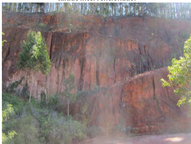
Figura 120. Sulcos em talude de corte com alta declividade.
