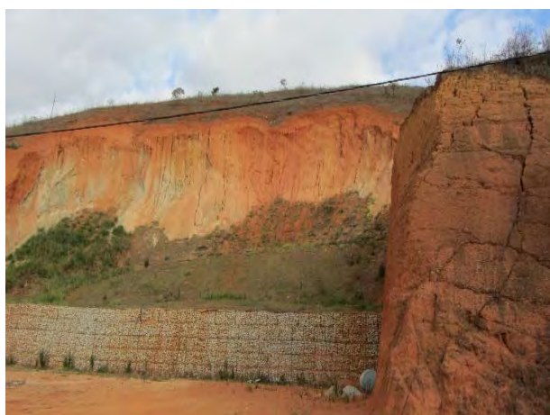
Figura 122. Sulcos em talude de corte parcialmente vegetado. Notar obra de contenção.
