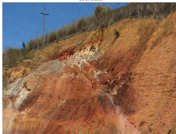
Figura 121. Sulcos erosivos em talude intervencionado.
