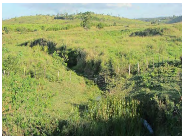
Figura 124. Ravina instalada em calha de drenagem.
