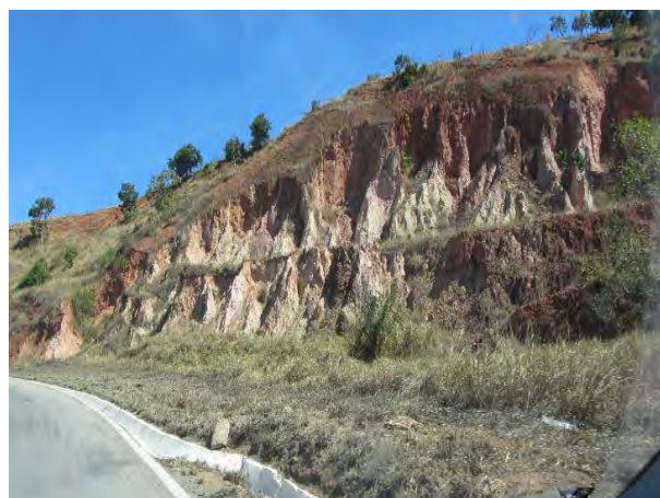
Figura 127. Ravinas em talude de corte escalonado.
