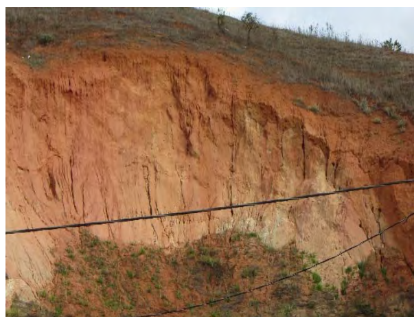
Figura 123. Detalhe dos sulcos em talude de corte. Notar sinais de abatimento.
