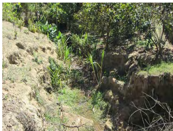
Figura 125. Ravina instalada em calha de drenagem.
