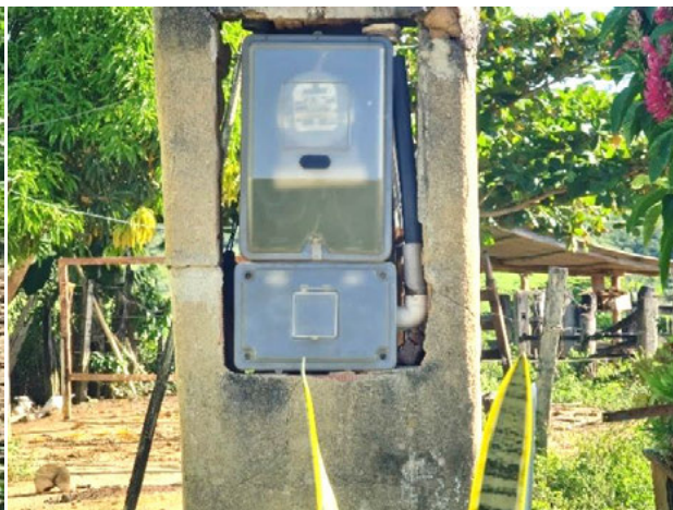
Foto 4-576: Medidor de energia na propriedade. Data: 21/02/21. Coordenadas UTM: 24K 372258E 8095774N.
