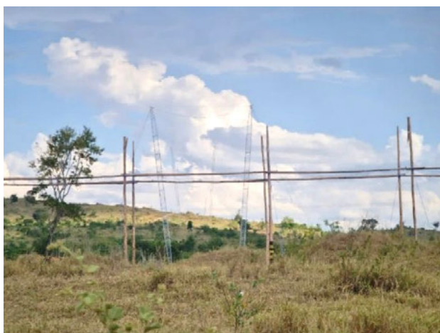
Foto 4-154: LT sendo construída no acesso para a fazenda. Data: 31/03/21. Coordenadas UTM: 24L 352636E 8324907N. Azimute: 175°.
