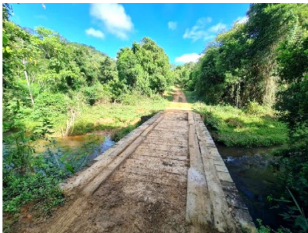
Foto 4-543: Vista da ponte sobre o rio Água Fria. Data: 23/03/21. Coordenadas UTM: 24K 371366E 8106220N. Azimute 340°.
