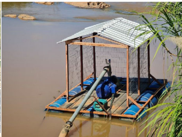
Foto 4-306: Captação de água no rio Jequitinhonha. Data: 27/03/21. Coordenadas UTM: 24K 349481E 8393795N.
