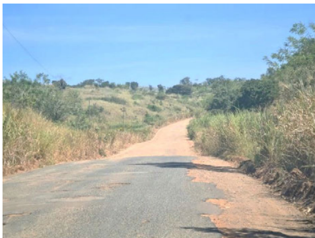
Foto 4-190: BA-130 em condições precárias. Data: 30/03/21. Coordenadas UTM: 24L 355375E 8281407N. Azimute: 285°.
