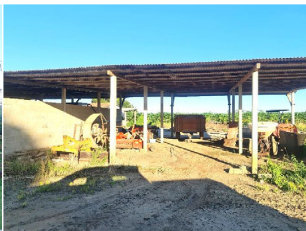
Foto 4-775: Visão geral do abrigo para os equipamentos. Data: 15/03/21. Coordenadas UTM: 24K 364615E 7995634N.
