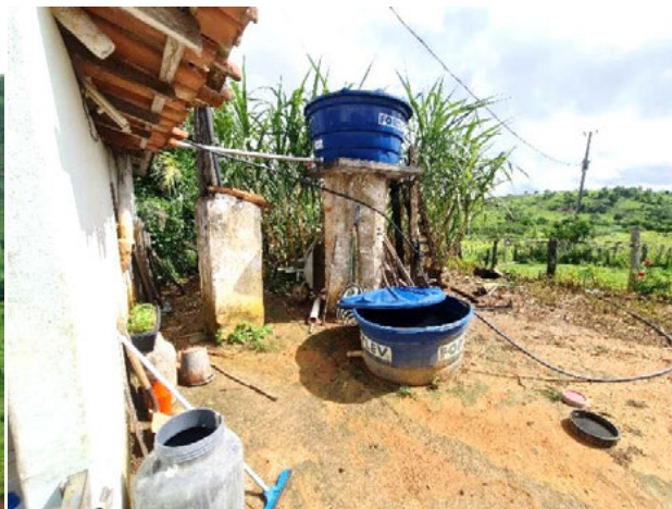
Foto 4-615: Sistema de armazenamento da água da cisterna na propriedade. Data: 28/03/21. Coordenadas UTM: 24K 373743E 8075631N.
