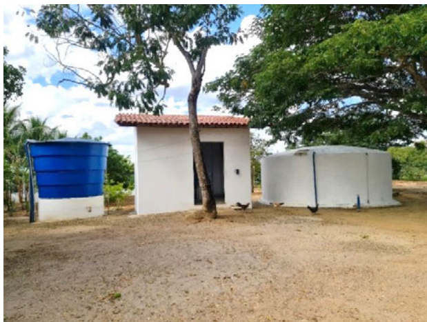
Foto 4-156: Sistema de bombeamento e armazenamento de água. Data: 31/03/21. Coordenadas UTM: 24L 356845E 8318188N.
