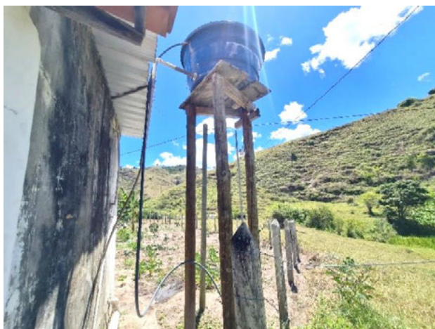
Foto 4-379: Armazenamento de água do poço artesiano. Data: 26/03/21. Coordenadas UTM: 24K 366981E 8169977N.
