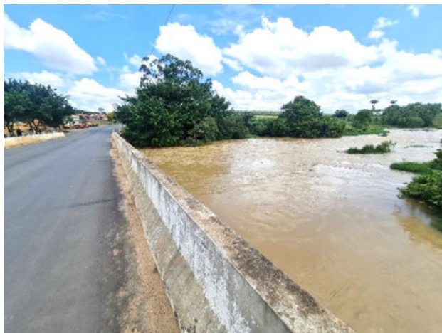
Foto 4-894: Vista da ponte sobre o rio São José, na divisa com rio Bananal na ES-432. Data: 11/03/21. Coordenadas UTM: 24K 357890E 7889544N. Azimute: 30°.
