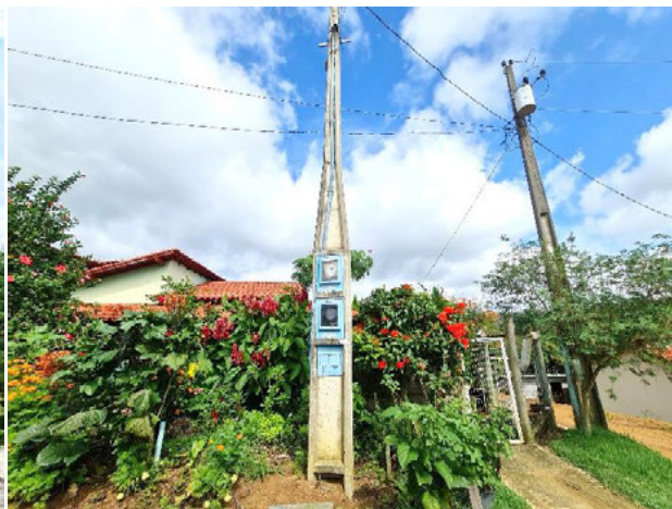
Foto 4-971: Medidor de energia no local. Data: 11/03/21. Coordenadas UTM: 24K 357642E 7876972N.
