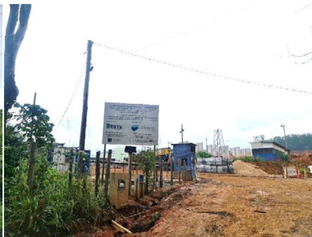
Foto 4-1035: Vista da obra de implantação da SE João Neiva 2. Data: 08/03/21. Coordenadas UTM: 24K 354158E 7813412N.
