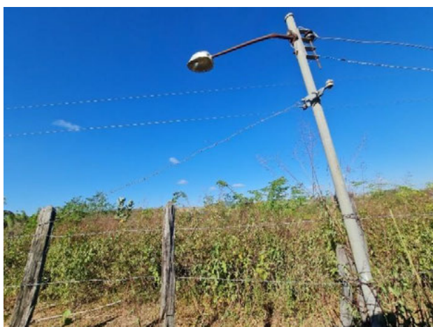
Foto 4-303: Iluminação pública no acesso para a Fazenda Monte Belo. Data: 28/03/21. Coordenadas UTM: 24K 365093E 8214339N.
