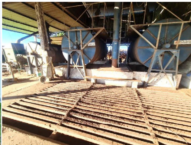
Foto 4-773: Vista do secador de café comunitário. Data: 15/03/21. Coordenadas UTM: 24K 364615E 7995634N.
