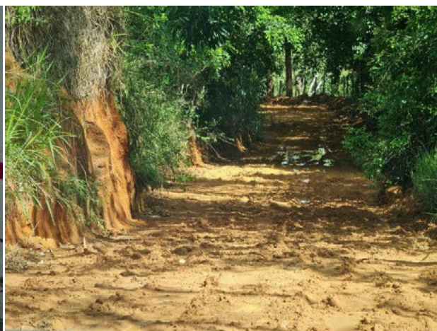
Foto 4-587: Acesso com muita lama para a Fazenda Oriente. Data: 21/03/21. Coordenadas UTM: 24K 372285E 8092950N. Azimute: 132°.
