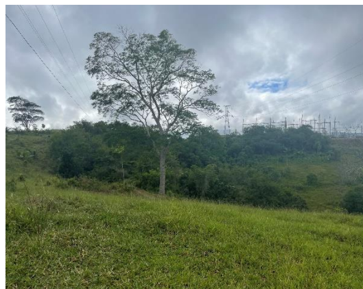
Foto 11 Subestação na Área do Projeto, município de Nova Venécia.
