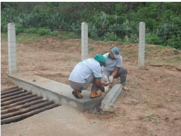
Foto 61 - Substituição de Mourão de concreto quebrado nas proximidades do mata-burro de acesso ao Dique II.
