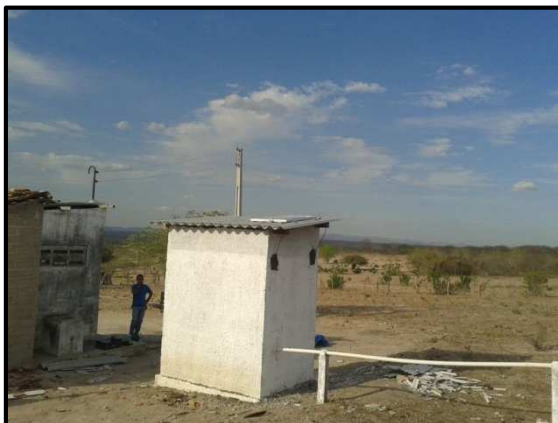
Figura 04: Mostra o passo a passo do reparo e reforço do abrigo da estação sismográfica de Xingó (XIN-01).
