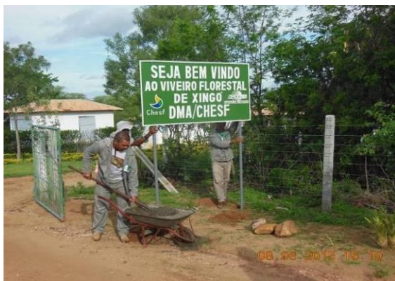
Foto 65 - Placa de sinalização instalada no acesso a entrada do Viveiro Florestal. Coordenadas UTM E 634674 e UTM N 8937407.
