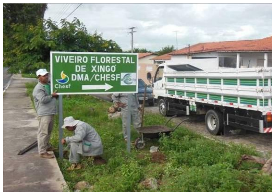
Foto 67 - Placa de sinalização instalada na Avenida Rio São Francisco. Coordenadas UTM E 634478 e UTM N 8937817.
