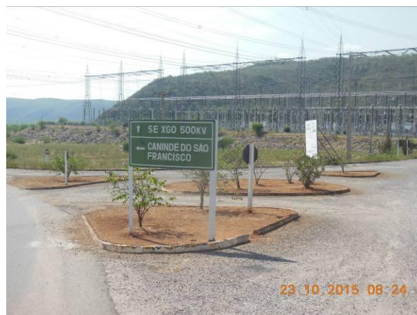
Foto 26 - Limpeza no trevo em frente à Subestação 500KW da UHE Xingó.
