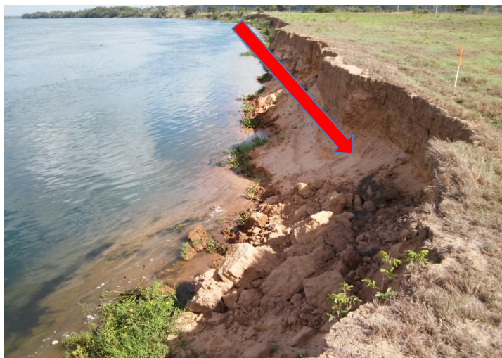
Figura 6.65- desmoronamento entre os perfis 2-A e 3
