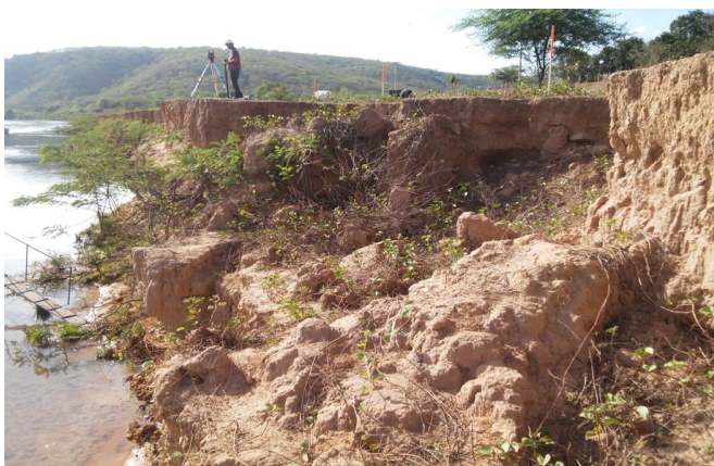
Figura 6.70 - Perfil 2-A Erosão pluvial
