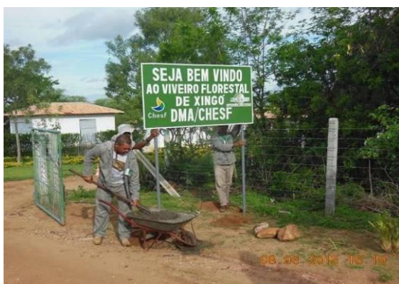
Foto 45 - Placa de sinalização instalada no acesso a entrada do Viveiro Florestal. Coordenadas UTM E 634674 e UTM N 8937407.
