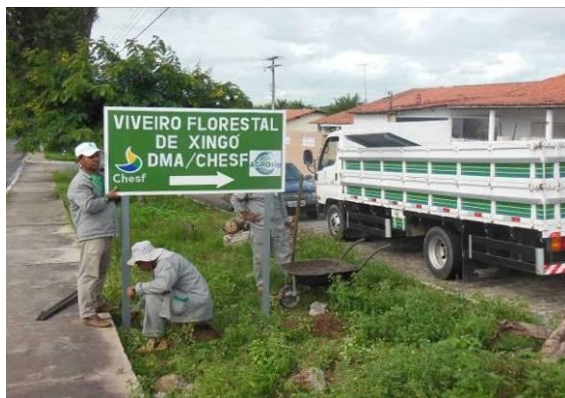
Foto 47 - Placa de sinalização instalada na Avenida Rio São Francisco. Coordenadas UTM E 634478 e UTM N 8937817.
