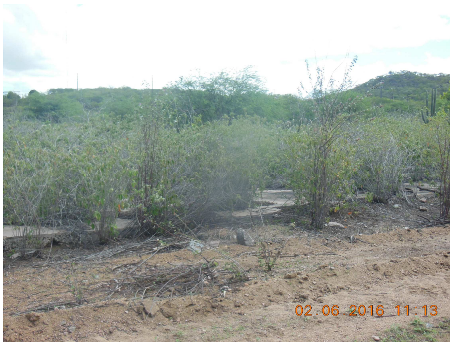
Figura 05. Exemplo de piso de concreto com uma colonização parcial dentro da área 05.
