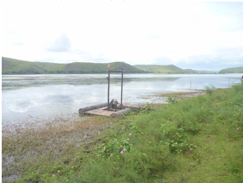
Bomba de captação da DESO-SE sem nenhum tipo de proteção no seu entorno
