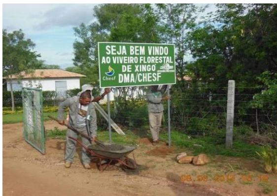
Foto 63 - Placa de sinalização instalada no acesso a entrada do Viveiro Florestal. Coordenadas UTM E 634674 e UTM N 8937407.
