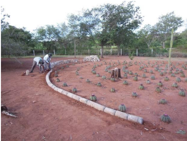
Foto 51 - Trabalhos de construção da área de coleta de sementes de Matrizes de Melocactus sp.
