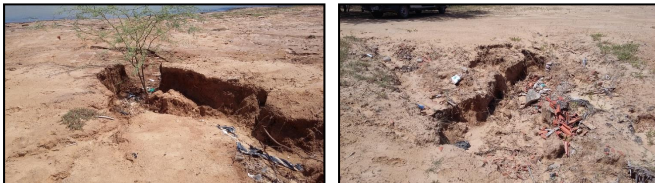
Figura 2.6. Visão de pontos de erosão devido as chuvas, ausência de cobertura vegetal e uso antropico.
