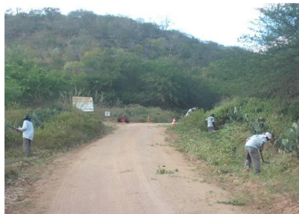
Foto 48 - Limpeza e roço na base da cerca viva no acesso ao Instituto Xingó até o dique II.
