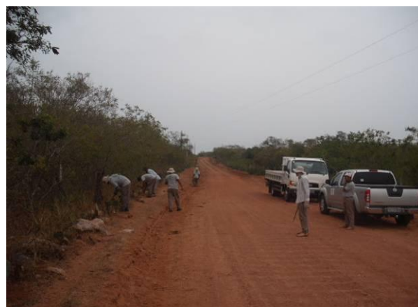
Foto 50 - Plantio de raquetes de palma espinhos e roço nas margens do acesso principal, próximo da área 11.
