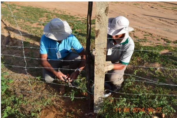
Foto 55 - Detalhe de manutenção da cancela de arame nas proximidades do mata-burro de acesso ao Dique III.
