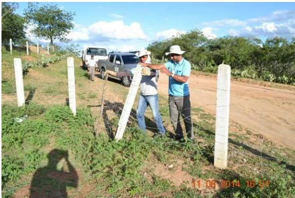
Foto 53 - Substituição de estaca de concreto rompido nas proximidades do mata-burro de acesso ao Dique III.
