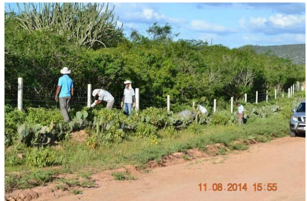
Foto 56 - Manutenção e reaperto de arame farpado e fixação com arames lisos nº 16 e 18 da cerca de concreto.
