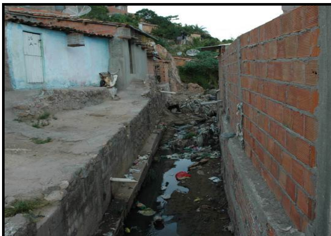
Figura 2.47. Macrodrainagem da Área Urbana da Sede de Mata Grande evidenciando escoamento de esgotos a céu aberto
