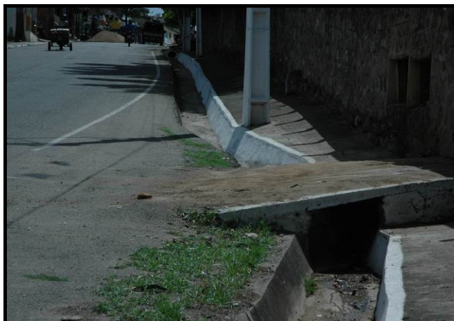
Figura 2.28. Vista do Sistema de Drenagem Urbana em Água Branca
