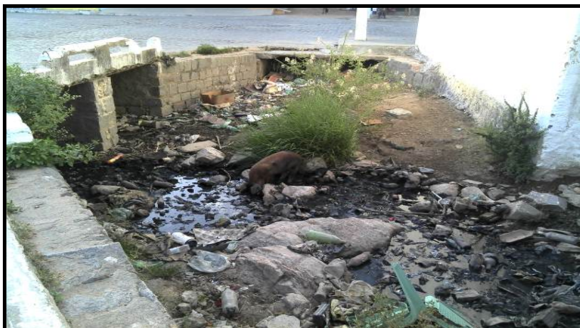
Figura 2.48. Macrodrainagem da Área Urbana do povoado de Santa Maria do Deserto evidenciando escoamento de esgotos a céu aberto
