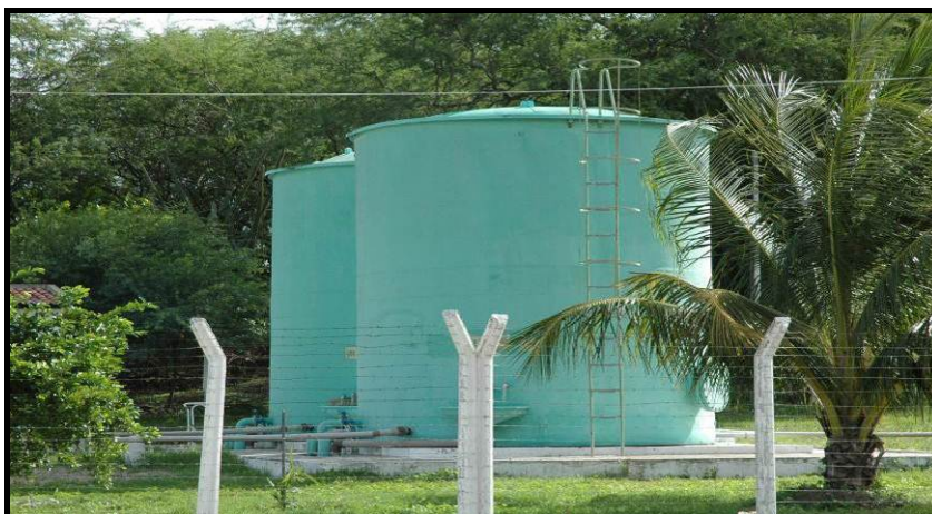
Figura 2.36. ETE Compacta - Bairro Novo - Área Urbana de Delmiro Gouveia
