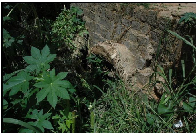
Figura 2.27. Vista do Sistema de Drenagem da Sede de Água Branca, inclusive com lançamentos de esgoto "in natura"
