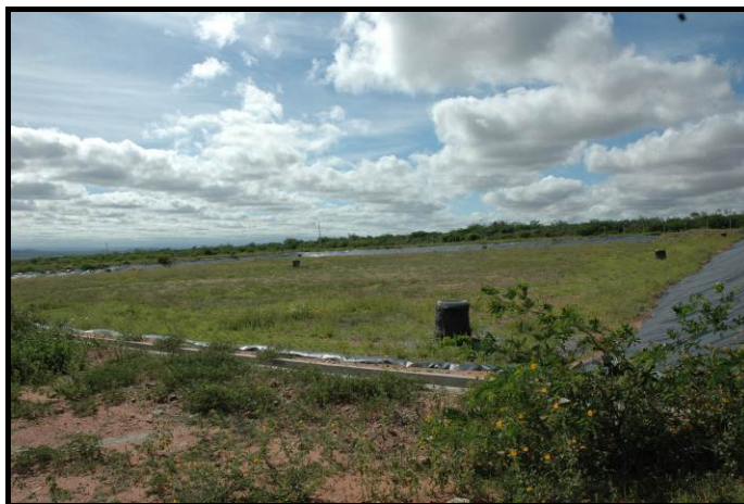
Figura 2.5. Lagoa de Estabilização não concluída
