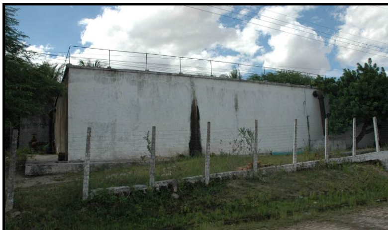
Figura 2.44. Reservatório Apoiado em Santa Maria do Deserto
