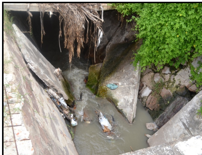
Figura 2.51. Drenagem urbana em Paulo Afonso, transformado em coletor de esgotos "in natura" que afluem para a antiga Usina Piloto
