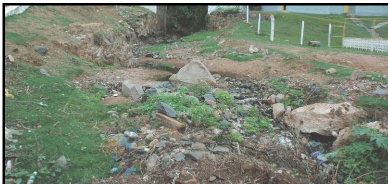
Figura 2.40. Macrodrenagem com problemas de sedimentos urbanos e queda de barreiras
