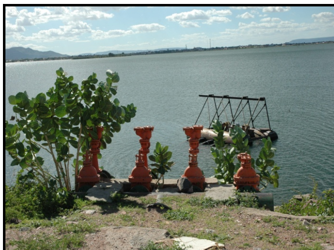
Figura 2.47. Segunda Captação de água pela EMBASA - Paulo Afonso para abastecimento humano, inclusive com sistema de tratamento
