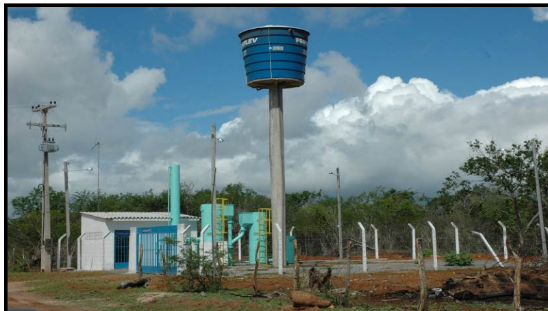
Figura 2.4. Sistemas compactos de abastecimento de água em comunidades rurais - CODEVASF - Comunidade do Talhado
