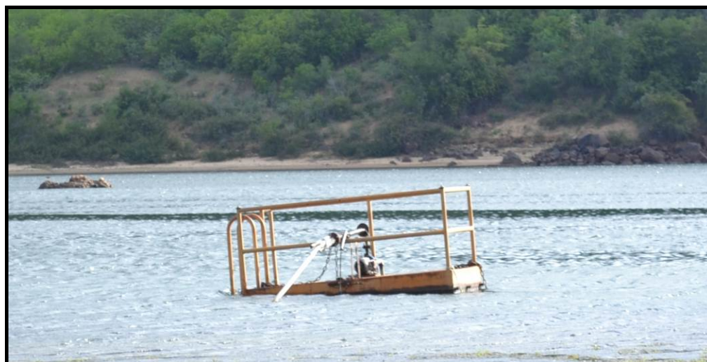
Figura 2.31. Captação em Entremontes
