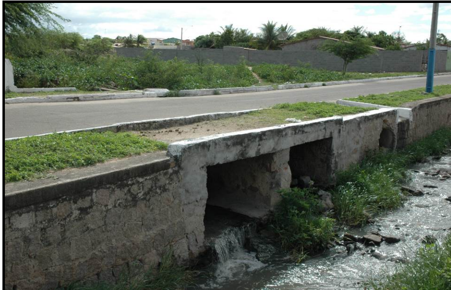
Figura 2.5. Coletor de esgoto lançando na macrodrenagem na Área Urbana de Delmiro Gouveia
