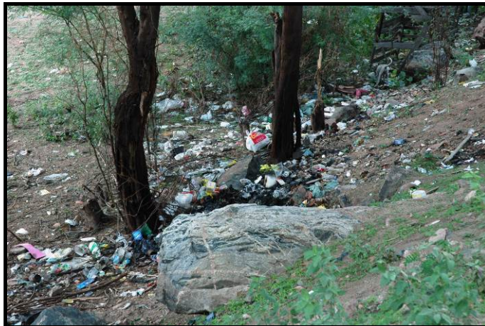
Figura 2.54: Depósitos de resíduos urbanos sem nenhum tipo de condicionamento no talude montante do maciço da barragem de Apolônio Sales
