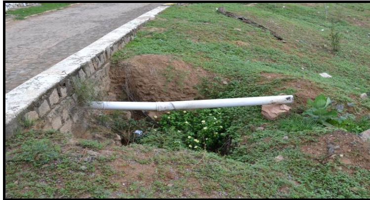
Figura 2.33. Local de lançamento de esgotos "in natura" na Orla de Piranhas - AL
