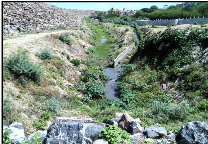
Figura 2.52: Dreno de jusante do maciço da barragem de Paulo Afonso IV, transformado em coletor de drenagem urbana e esgotos "in natura"
