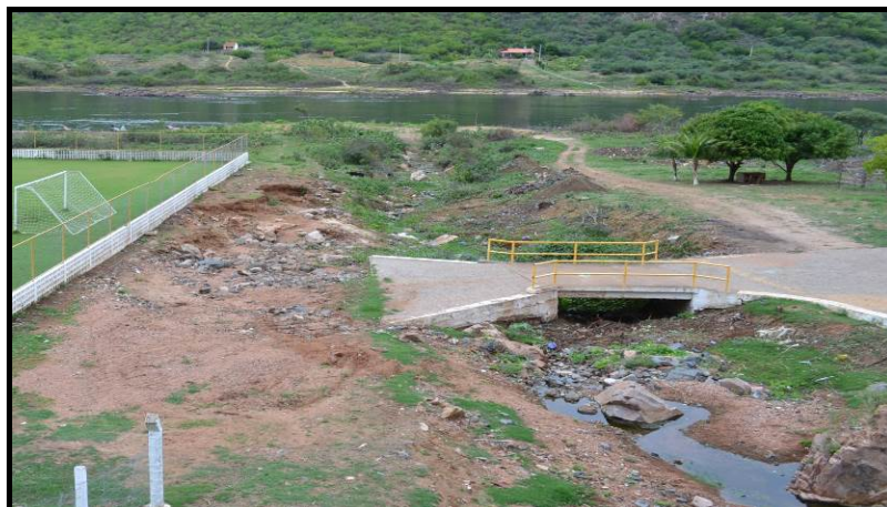
Figura 2.41. Macro drenagem com problemas de sedimentos urbanos e queda de barreiras
