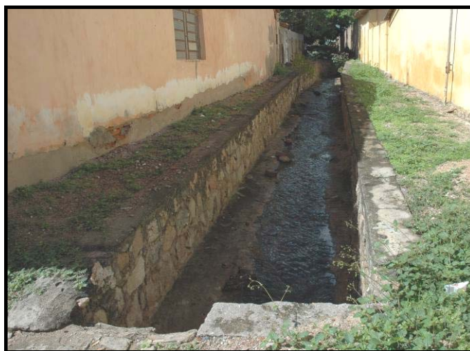
Figura 2.10. Drenagem do povoado Barragem Leste
