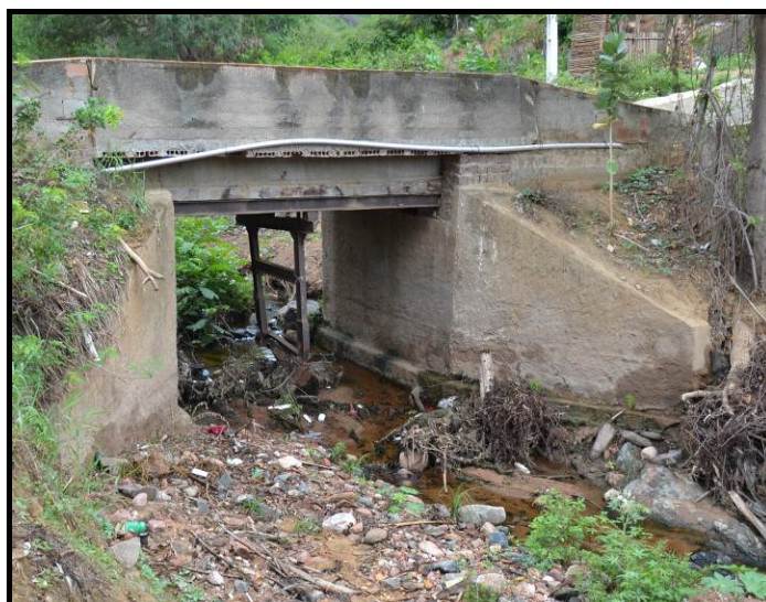
Figura 2.42. Macro drenagem com problemas de sedimentos urbanos e queda de barreiras
