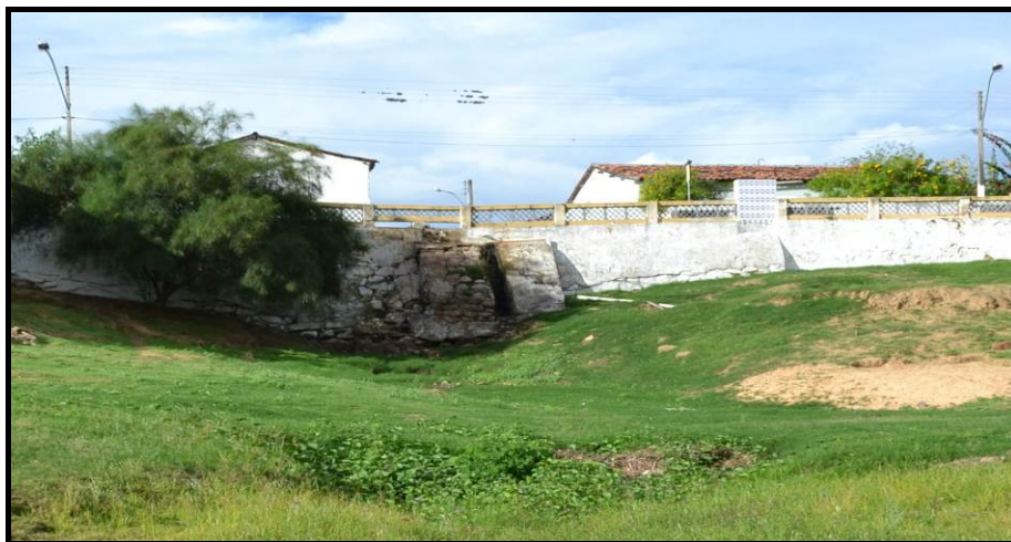
Figura 2.35. Local de lançamento de esgotos "in natura" na Orla de Entremontes - AL
