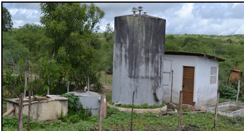
Figura 2.19. Estação de Tratamento de Esgotos em Olho D'água do Casado
