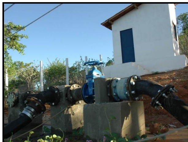
Figura 2.23. Captação de água da CODESVASF para abastecimento humano
