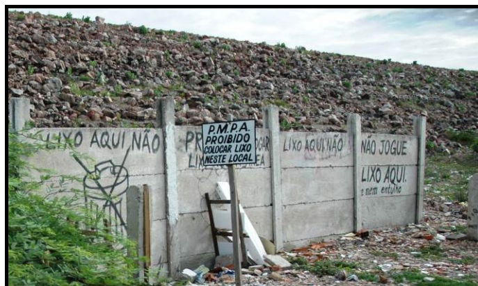
Figura 2.36. Depósitos de resíduos urbanos sem nenhum tipo de condicionamento próximo ao dreno de jusante do maciço da barragem de Paulo Afonso IV
