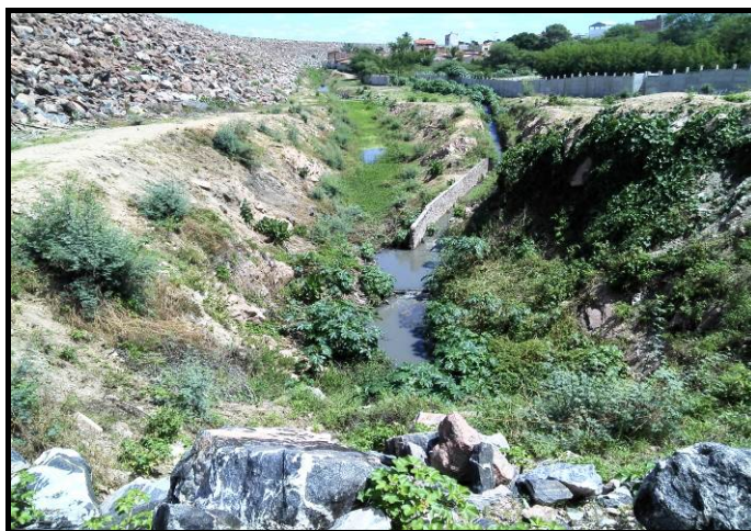
Figura 2.35. Dreno de jusante do maciço da barragem de Paulo Afonso IV, transformado em coletor de drenagem urbana e esgotos "in natura"
