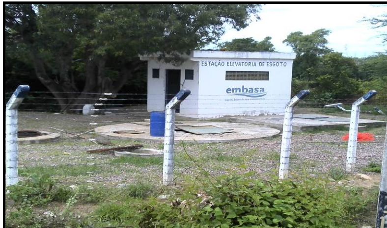
Figura 2.31. Estação Elevatória de Esgoto - EMBASA - Paulo Afonso - BA, aparentemente fora de operação
