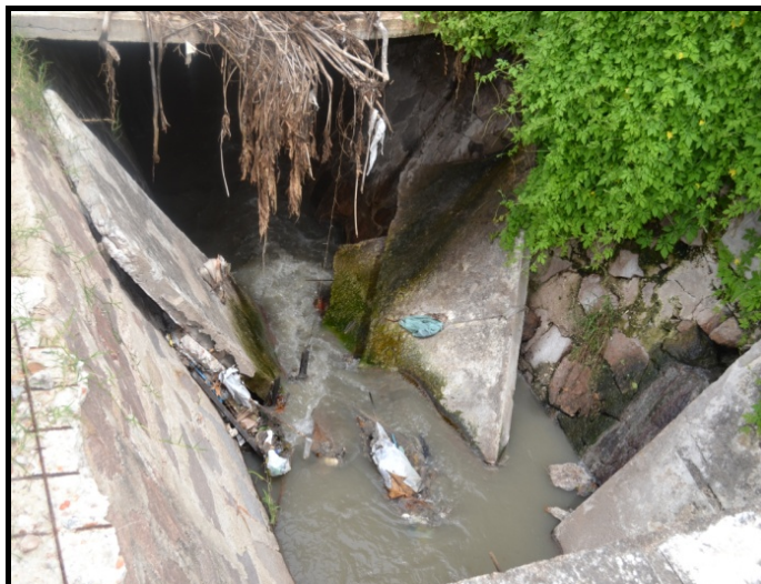
Figura 2.34. Drenagem urbana em Paulo Afonso, transformado em coletor de esgotos "in natura" que afluem para a antiga Usina Piloto
