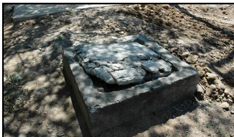
Figura 2.16. Macro drenagem da Área Urbana da Sede de Jatobá evidenciando escoamento de esgotos " in natura "
