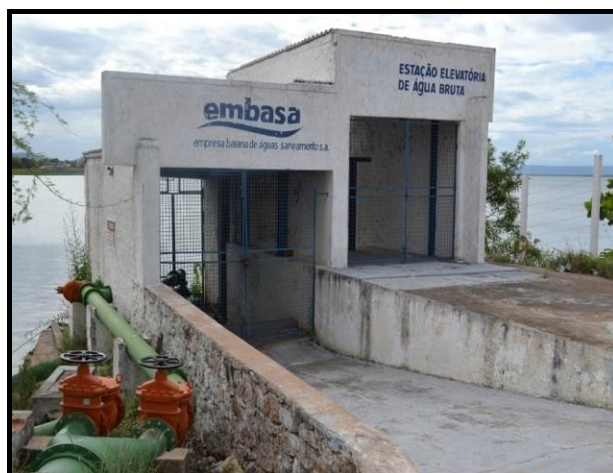
Figura 2.28. Primeira Captação de água pela EMBASA - Paulo Afonso para abastecimento humano, inclusive com sistema de tratamento
