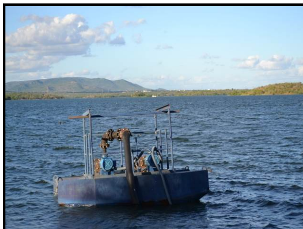
Figura 2.22. Captação de água da CODESVASF para abastecimento humano
