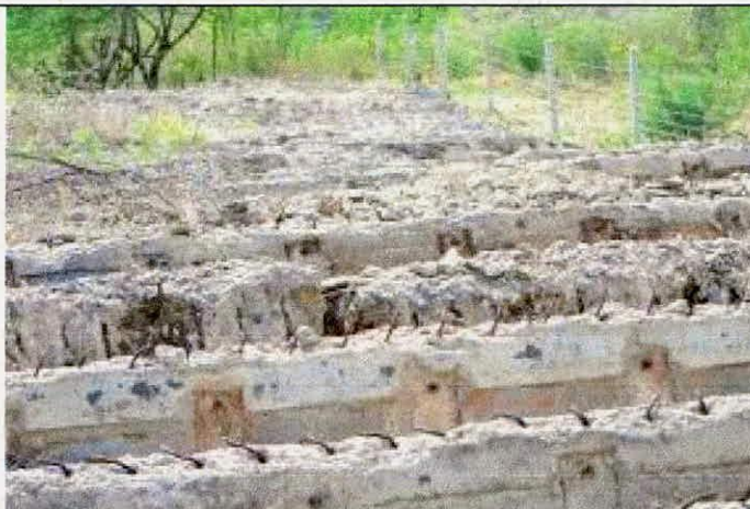
Figura 02. Estrutura em concreto, depredada para se obter armadura.
