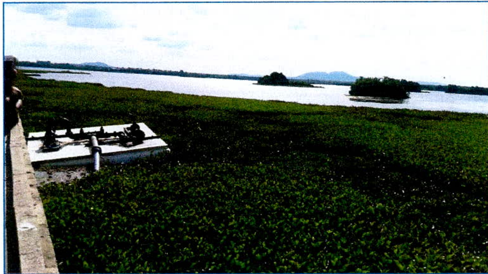
Captação da CASAL no Reservatório Delmiro Gouveia - AL
