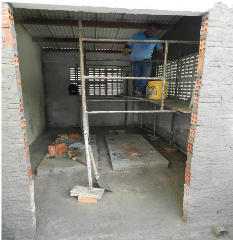
Figura 46: Obra no futuro local onde será instalado o novo sistema de captação de água de Penedo-AL.Fonte: IBAMA.
