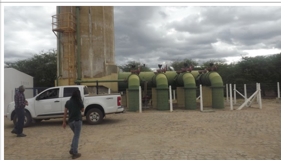
Foto 13: Captação do projeto Fulgêncio, no município de Santa Maria da Boa Vista. Coordenadas: 8°38'23.11"S e 39°40'24.41"W.
