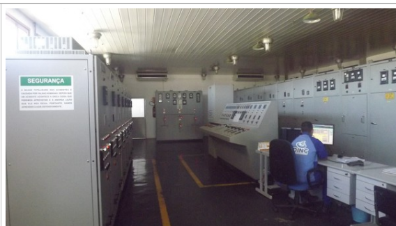
Foto 9: Sala de operação da captação de água do Perímetro Irrigado Nilo Coelho. Coordenadas: 9°22'14.88"S e 40°48'8.90"W.
