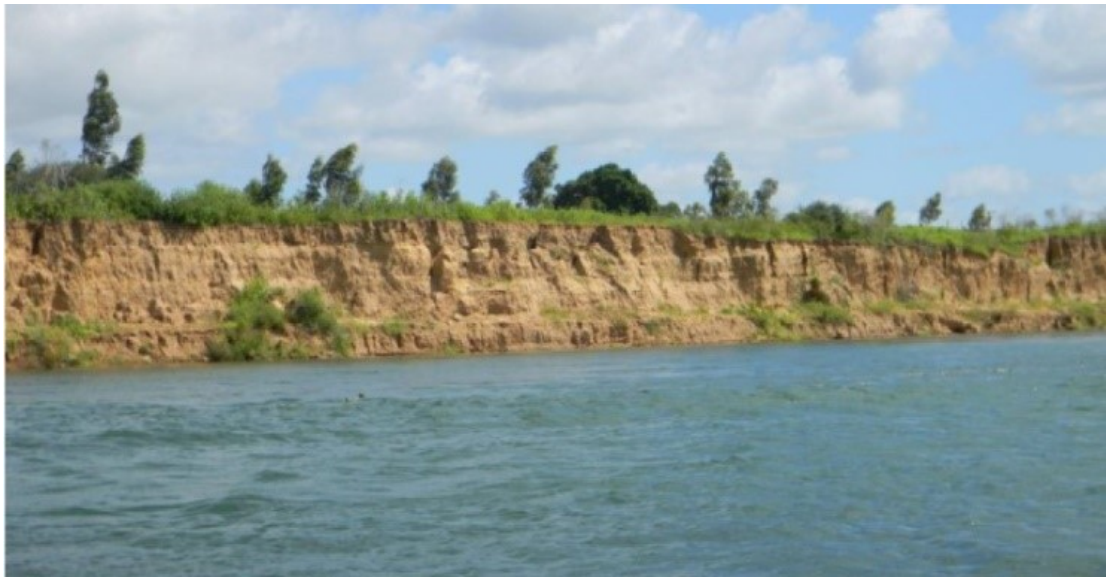
Figura 15.2- Margens do rio São Francisco com processos erosivos em Santana do São Francisco. Fonte: Araújo (2013).
