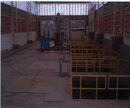
Captação do Canal do Sertão Alagoano – instalada às margens do Reservatório de Moxotó (09°20'23.86"S, 038°11'35.06"O), não se verificou qualquer problema com a sua operação.
