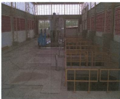
Captação do Canal do Sertão Alagoano – instalada às margens do Reservatório de Moxotó ( 09^{\circ}20'23.86''\text{S} , 038^{\circ}11'35.06''\text{O} ), não se verificou qualquer problema com a sua operação.
