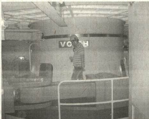
FOTO 25: Instalações da Usina Xingó.
