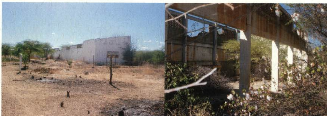
Foto 1 e 2: aspectos de estruturas abandonadas no antigo canteiro de obras de Sobradinho – algumas apresentando vegetação de porte significativo (fonte: Relatório de vistoria DEMG/Chesf, jul/2011)
