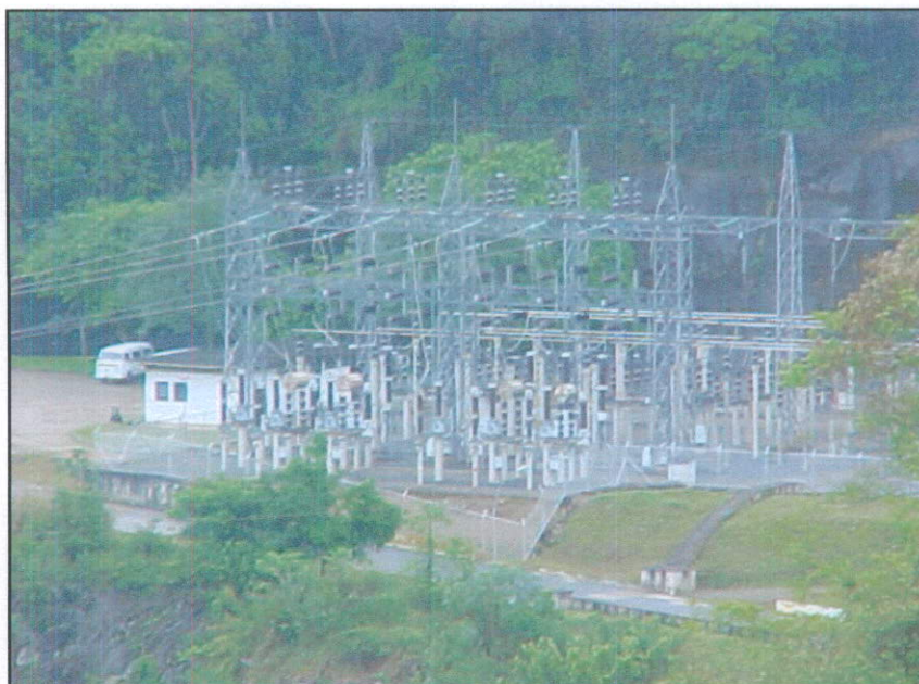
Foto 20 – Vista da subestação principal de 138 kV (FONTE: MRS).
