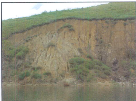
Foto 44 – Vista de erosão na margem do reservatório (FONTE: MRS).
