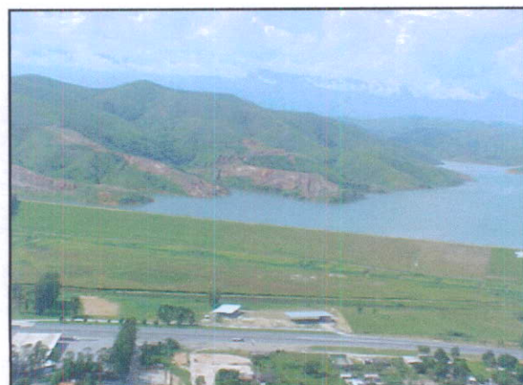
Foto 40 – Vista das erosões localizadas em frente ao Dique de Nhangapi (FONTE: MRS).
