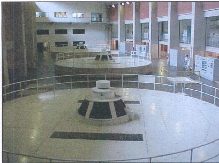
Foto 17 – Plataforma dos geradores (FONTE: MRS).
