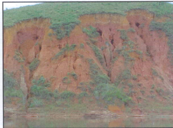
Foto 47 – Vista de outro ponto de erosão, sentido sul (FONTE: MRS).
