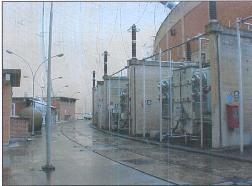
Foto 15 – Vista dos transformadores principais (FONTE: MRS).
