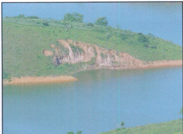
Foto 36 – Vista de erosão com área de pastagem (FONTE: MRS).
