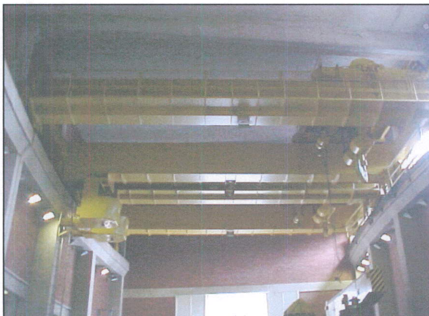
Foto 18 – Vista da ponte rolante da plataforma dos geradores (FONTE: MRS).
