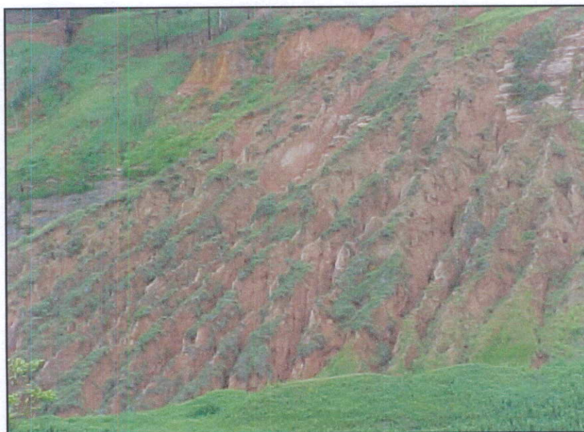
Foto 27 – Vista da erosão em detalhe (Localização: Mapa 11, Foto 13) (FONTE: MRS).
