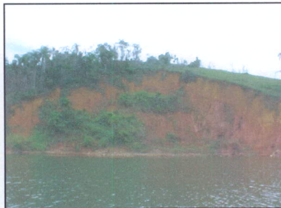
Foto 45 – Vista de outro ponto de erosão em sentido norte (FONTE: MRS).
