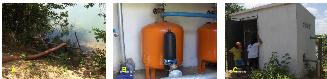
Figura 5.6 A e B e C Captação e Casa de Bombas do PA Malhada Real – Município de Lagoa Grande (PE)
