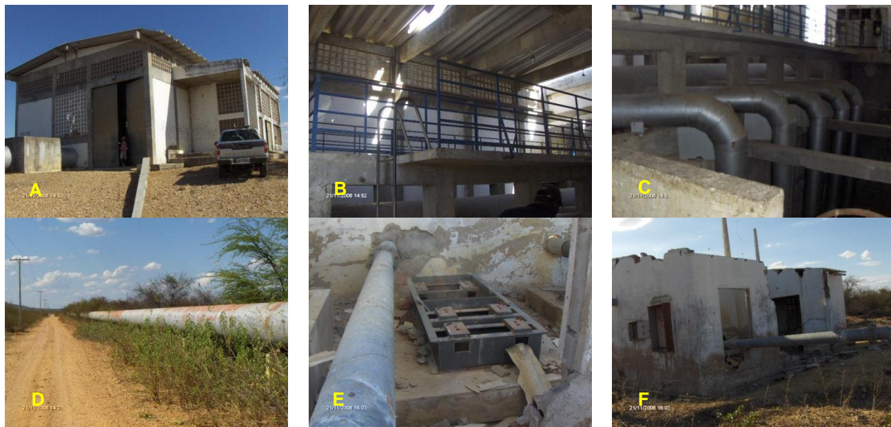
Figura 4.43 A, B, C, D, E e F PA Catalunha – infraestrutura de captação e bombeamento d'água - Santa Maria da Boa Vista (PE)
