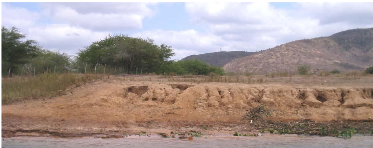
Figura 3.3 Barrancos marginais do rio São Francisco, próximo à Orocó - PE, mostrando as feições decorrentes da severa erosão a que estão submetidos
