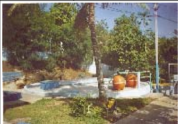
FOTO 05 - Reservatório enterrado de água tratada, sede Adrianópolis – PR.
