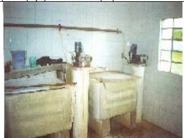
FOTO 04 – Estação de Tratamento de água, cloração sede Dr. Ulysses-PR.
