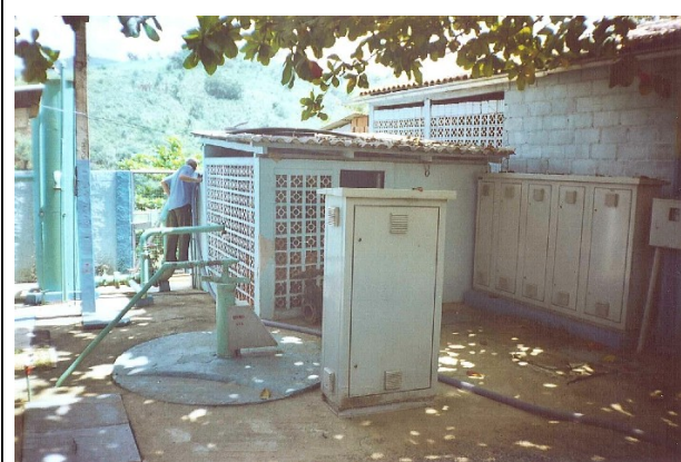
FOTO 09 – Captação de água para abastecimento público, poço profundo (inativo) e chegada de captação de água de mina. Vila Mota, Adrianópolis-PR
