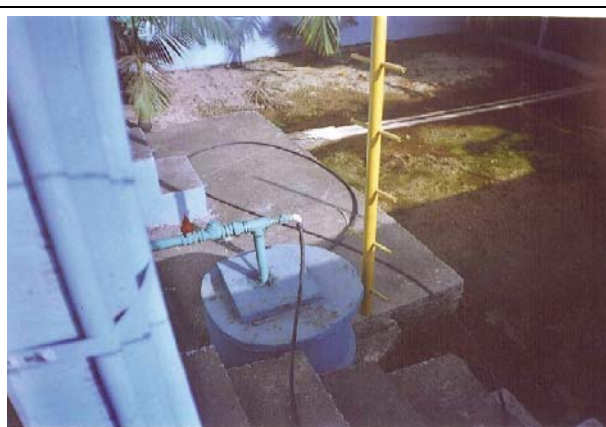
FOTO 08 – Captação de água para abastecimento público, poço profundo sede Adrianópolis. Detalhe.
