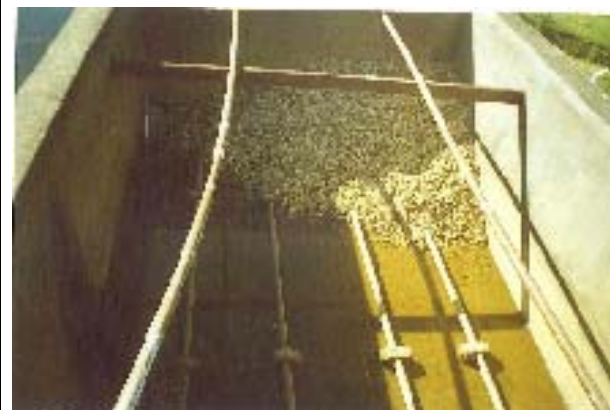
FOTO 21 - Tanque de Floculação desativado. ETA em reforma, Bairro Saltinho, município de Ribeira-SP.
