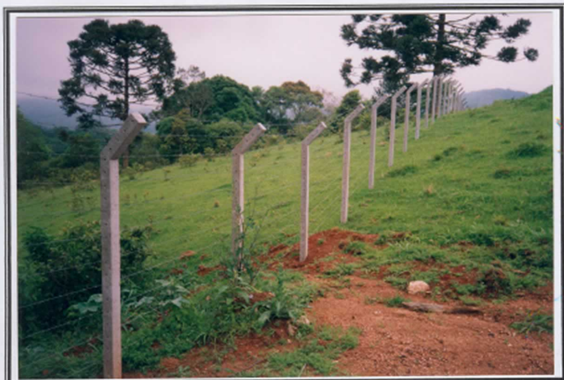
FOTO 4. Cercameno lateral esquerdo implantado, sem proteção vegetal.
