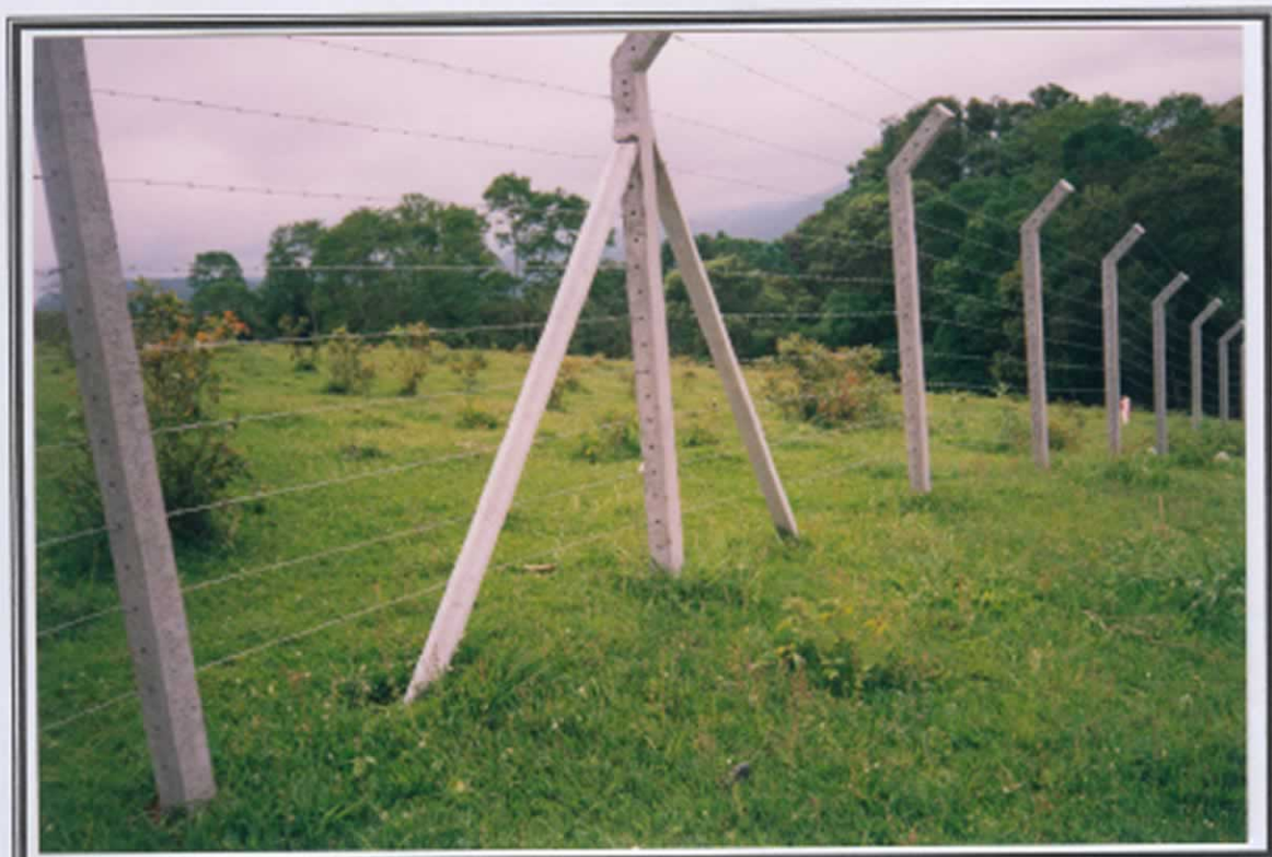
FOTO 10. Cercamento executado, sem a proteção ambiental.
