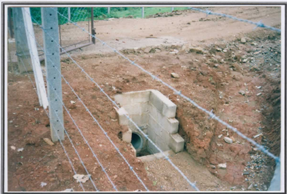
FOTO 12. Sistema de drenagem implantado na entrada do aterro sanitário.
