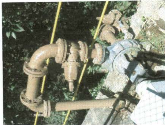
Foto 40 – Bomba de captação de água no Rio Ribeira.
