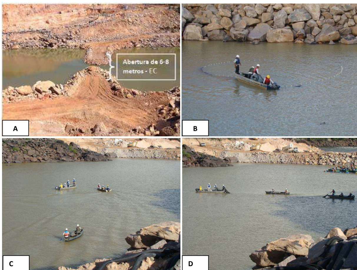
Prancha 04. (A) Detalhe do canal deixado para afugentamento dos peixes do interior da área ensecada, trecho entre as ensecadeiras de montante e central; (B, C e D) detalhe da utilização de embarcações e redes de arrasto de grande extensão para afugentamento dos peixes da área ensecada – UHE Teles Pires, junho/julho/agosto 2013.
