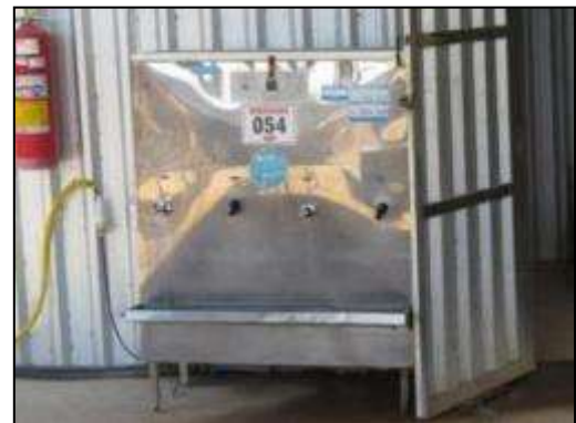
Bebedouro da central de ar MD.
