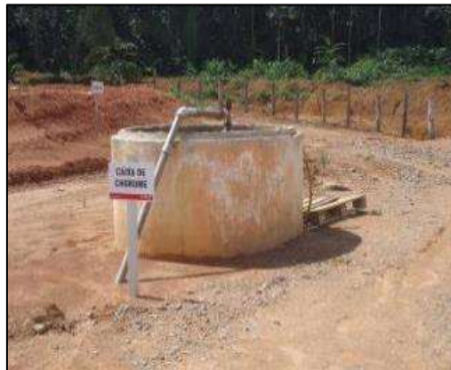
Caixa de chorume CGR- Sistema de bomba automatizado para transporte direto para tratamento na ETE II.
