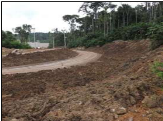
Área da oficina de terceiros da Margem Esquerda após a desmobilização, em Janeiro de 2014.
