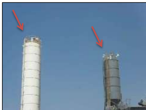
Silos de cimento com filtro para retenção de partículas em suspensão.
