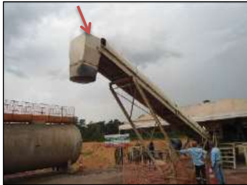
Instalação de esteiras envelopadas da usina de concreto e com chute de descarga.
