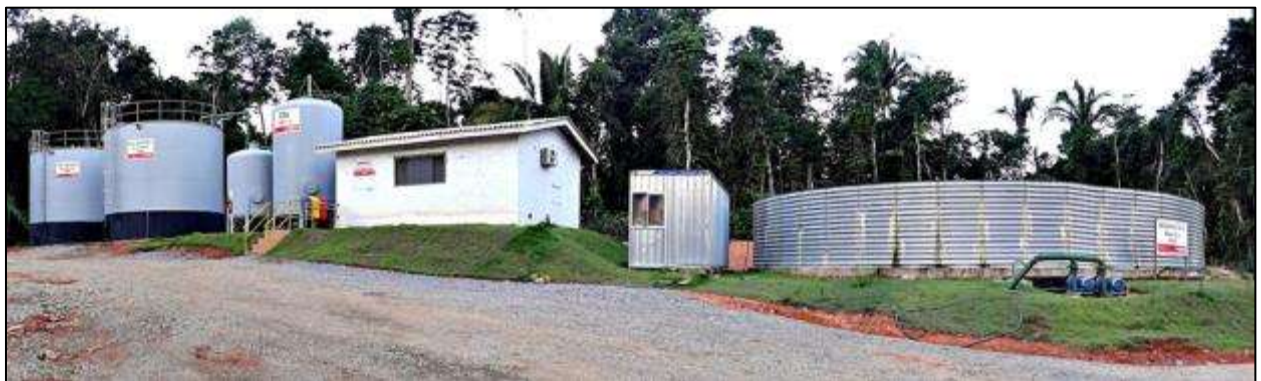
Estação de Tratamento de Água.
