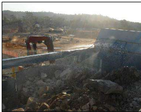
Sistema de aspersão de água britador.
