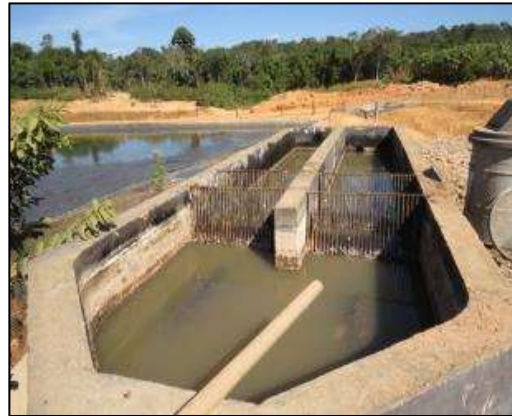
Caixa desarenadora da entrada na ETE02.
