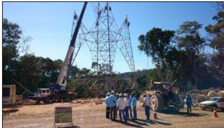
Atividade de montagem das torres da linha de transmissão no canteiro de obras.
