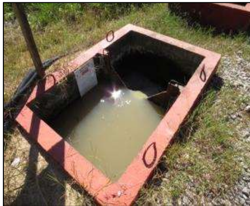
Medidor de vazão das estações de tratamento.
