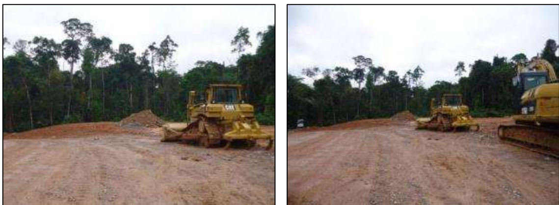
Trator de esteira espalhando o solo vegetal após a desmobilização das estruturas do escritório de produção do Emboque.
