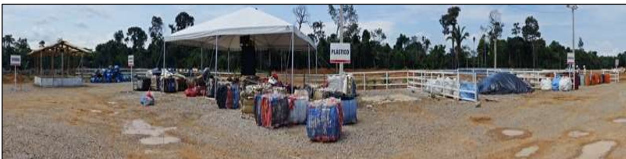
Baias de segregação de resíduos recicláveis.
