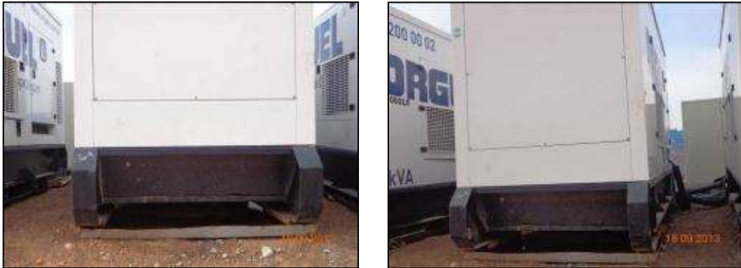
Geradores no campo com bandeja de contenção.
