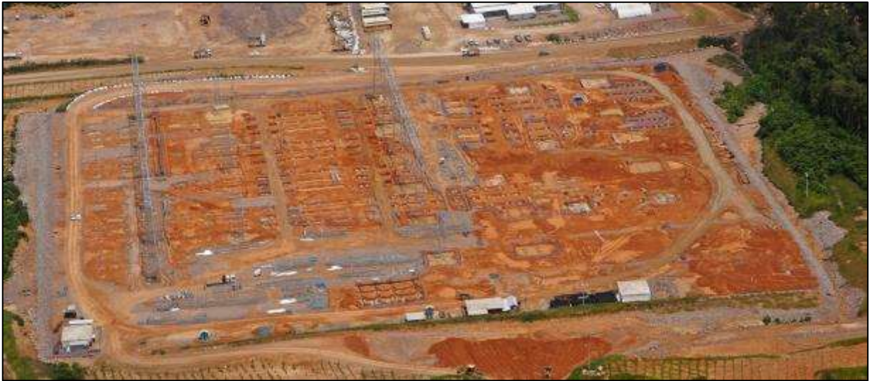
Vista aérea da área de implantação da subestação de manobra situada na margem direita do canteiro de obras da UHE Teles Pires.
