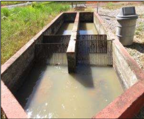
Caixa desarenadora da entrada na ETE01.
