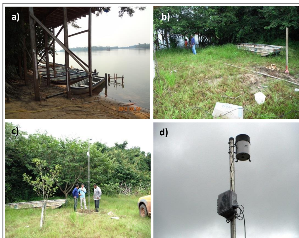
Figura 4. Processo de instalação da estação hidrométrica Cajueiro do Teles Pires, incluindo lance de réguas (a); instalação do sensor de nível (b); vista geral da estação (c); e pluviômetro com datalogger (d).
