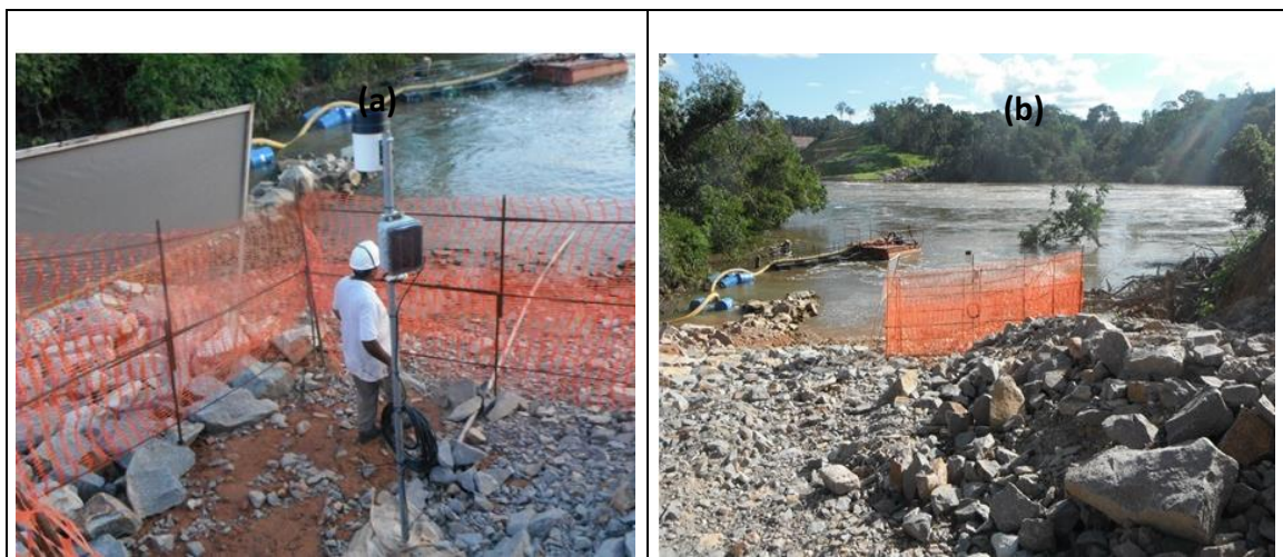
Figura 8. Montagem e instalação da estação telemétrica UHE. (a) Visão geral da estação sendo montada; (b) Visão geral do local escolhido para a instalação da estação.
