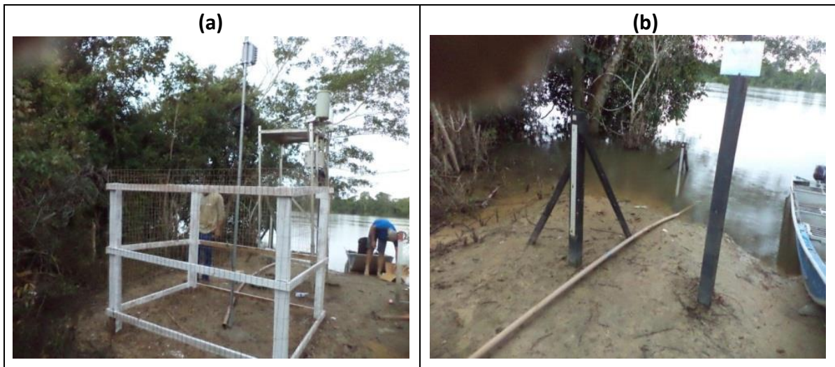
Figura 11. Montagem e instalação da estação telemétrica Jusante Foz Peixoto de Azevedo. (a) Visão geral da estação sendo montada; (b) Visão geral do local escolhido para a instalação da estação.
