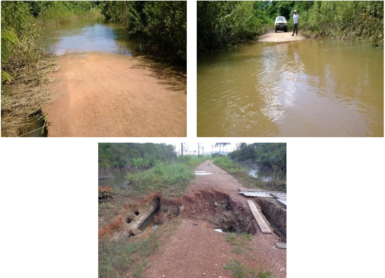
Figura 14 – Acesso interdito aos PM01, PZ01 e PZ02 nos meses de março e abril de 2014.
