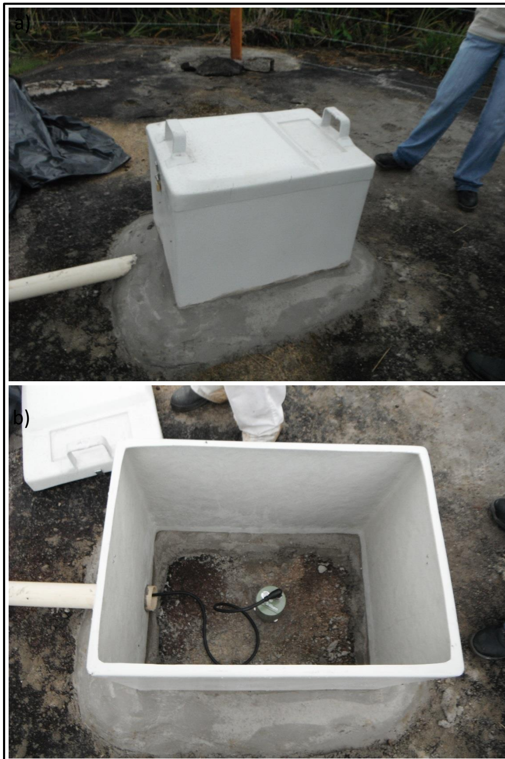
Figura 4 – Estação Sismográfica UHE Teles Pires 1 (STP1) na Fazenda Candinho, próxima ao rio Teles Pires. a) vista geral do abrigo do sensor (sismômetro). b) vista interna do abrigo do sensor com o sismômetro já instalado. O sensor deve sempre estar nivelado com o chão (isso é feito com o auxílio de uma bolha) e direcionado para o Norte, sendo que a direção do Norte deve ser obrigatoriamente corrigida com dados de sismos distantes.
