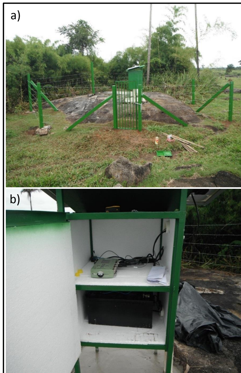
Figura 2 – Estação Sismográfica UHE Teles Pires 1 (STP1) na Fazenda Candinho, próxima ao rio Teles Pires. a) vista geral da estação e da cerca de proteção. b) vista do interior do abrigo do registrador, revestido com isopor para isolamento térmica parcial. Na prateleira de cima se encontra o registrador (peça verde) e o GPS, e na prateleira de baixo a bateria da estação, a qual é recarregada por um painel solar que se encontra sobre o abrigo do registrador.
