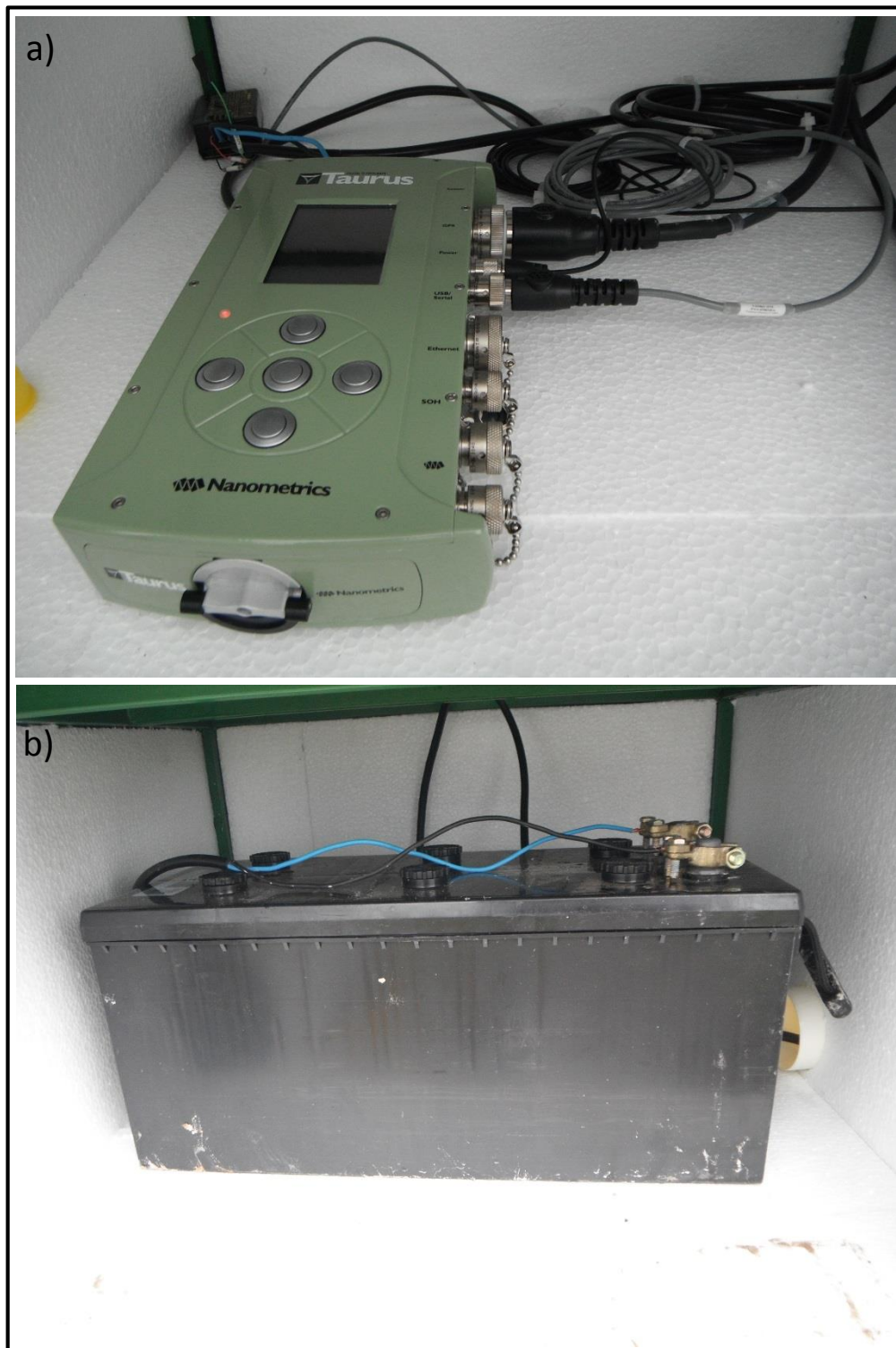
Figura 3 – Estação Sismográfica UHE Teles Pires 1 (STP1) na Fazenda Candinho, próxima ao rio Teles Pires. Em a) é mostrado o registrador e em b) bateria da estação.
