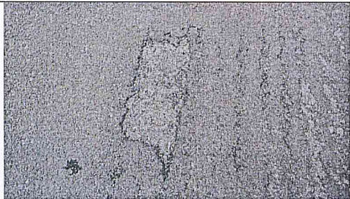
Descolamento entre camadas do pavimento
