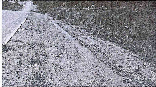
Ocorrência de início de processo erosivo na lateral da pista. Prever canaleta em concreto.
