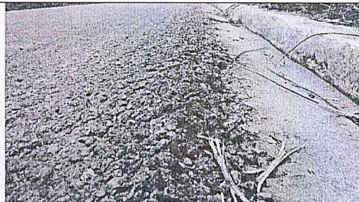
Diferença de nível entre o TSD e a Sarjeta impedindo que a água escoe para a sarjeta.
