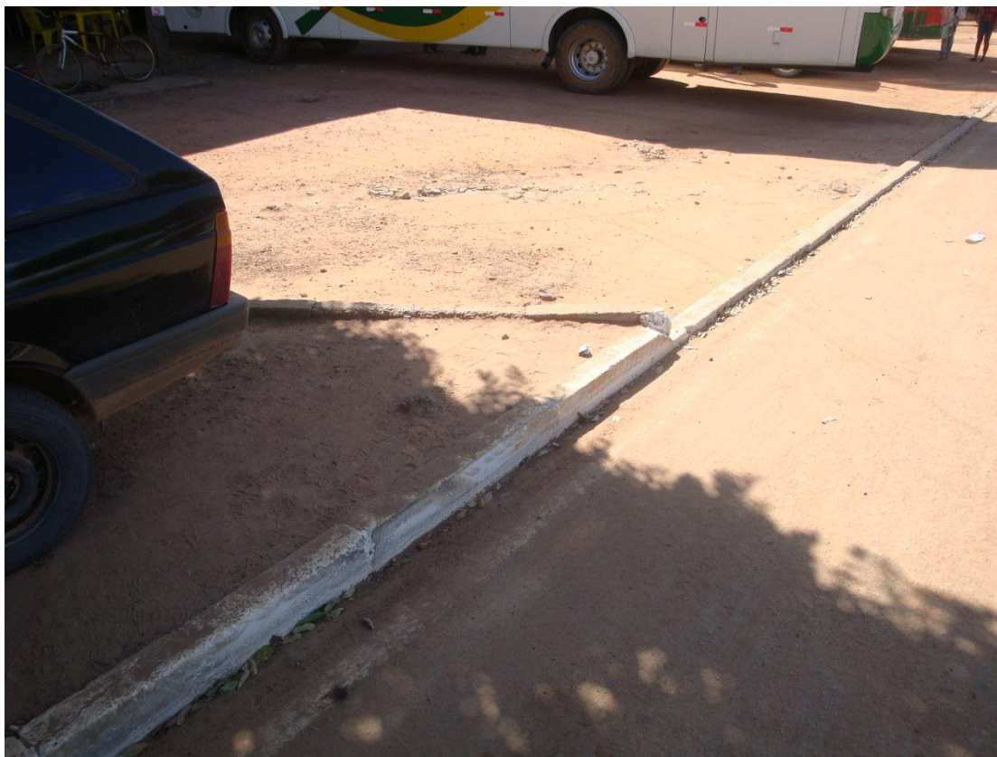
Figura 3: Ausência de Estacionamento para Veículos que acabam estacionando irregularmente sobre a calçada (inclusive sem calçamento).
