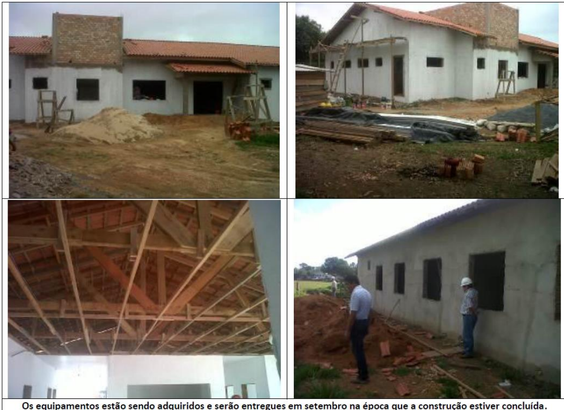
Os equipamentos estão sendo adquiridos e serão entregues em setembro na época que a construção estiver concluída.
