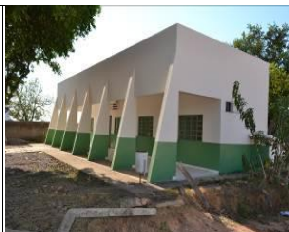
Figura 22b: Prédio depois da reforma pela CHTP do PSF Vila Nova para ser utilizado como Posto Policial.
