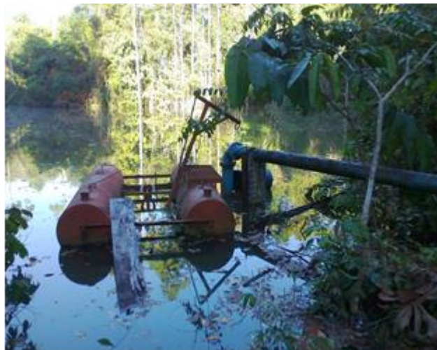
Fotografia 16. Represa e Ladrão de água da Represa do Sistema de Captação do DAE de Paranaíta.
