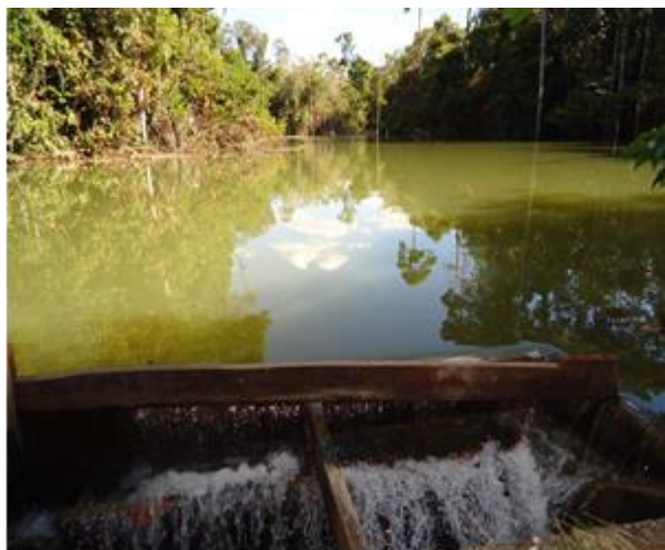
Fotografia 15. Bomba de Sucção do Sistema de Captação e Distribuição de Água do DAE de Paranaíta.
