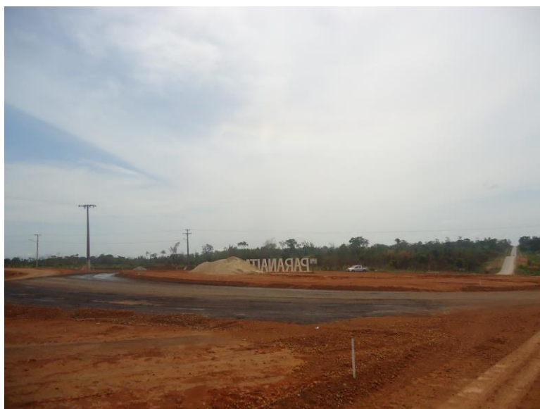
Fotografia 21. Trevo de Chegada em Paranaíta (MT-206), durante a etapa final das obras em 2013.
