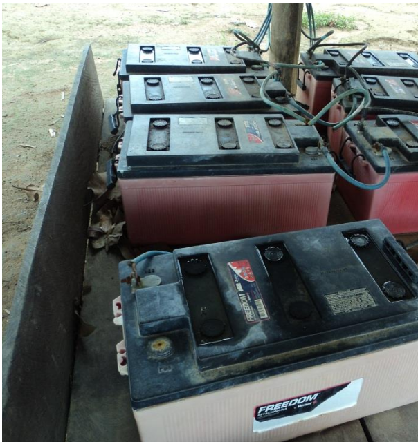
Figura 24: Visita técnica no sistema de energia solar na aldeia Mayrowi.
