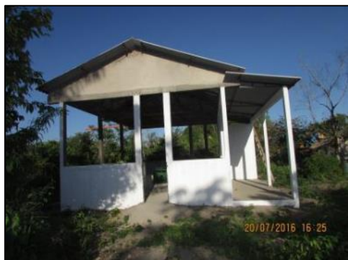
Foto 27 - Jul/16: Finalização de reboco e início da primeira demão da pintura externa.
