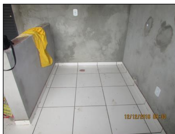
Foto 104 - Dez/16: Execução de reboco e instalação de revestimento cerâmico do piso da cozinha.
