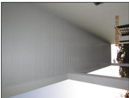
Foto 57 - Jul/16: Instalação de forro de PVC na área da varanda externa à edificação.
