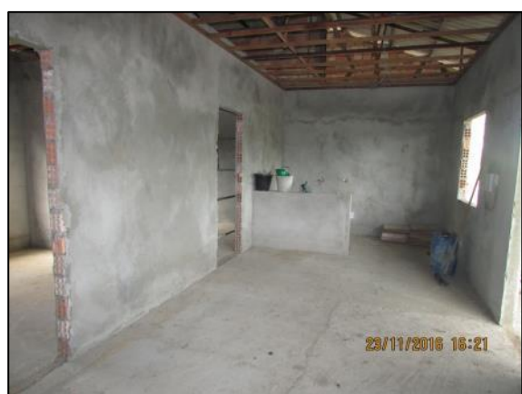
Foto 103 - Nov/16: Vista interna da Casa de Apoio, com execução de reboco da alvenaria e contrapiso.
