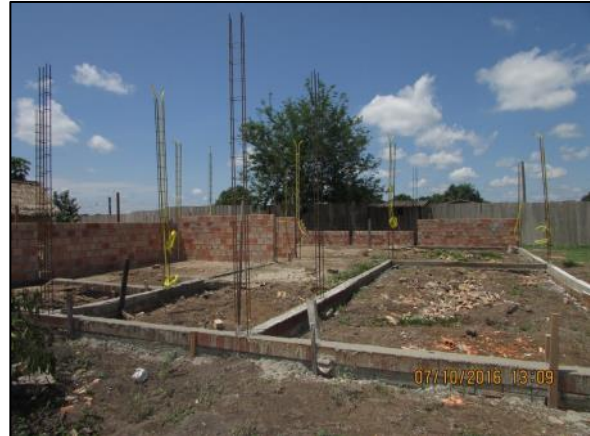
Foto 110 - Out/16: Execução de alvenaria e passagem de fiação embutida nos conduites para ligação elétrica.
