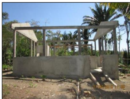
Foto 16 - Jul/16: Reboco de alvenaria externa e execução de rampa para acesso às portas.
