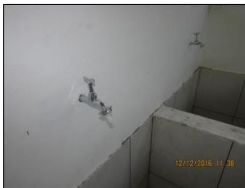
Foto 34 - Dez/16: Instalação de torneiras dos tanques.
