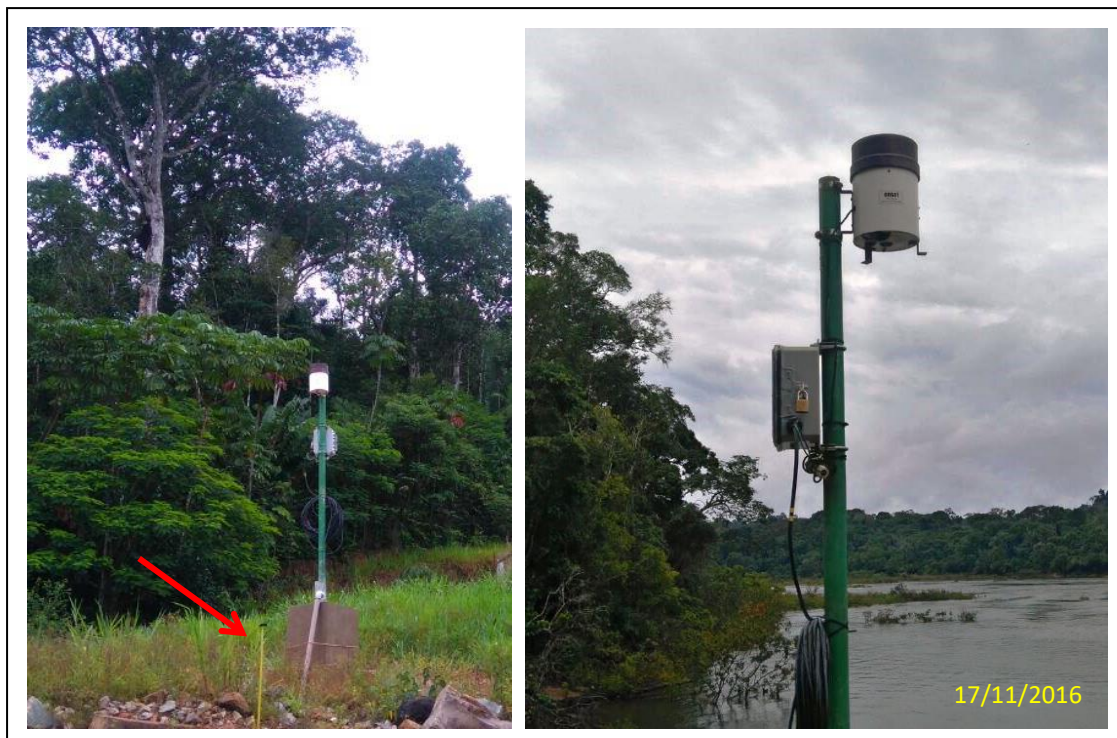
Figura 26. Estação hidrométrica UHE Teles Pires Jusante durante vistoria realizada no dia 17 de novembro de 2016. A seta em vermelho indica a estaca instalada próxima a estação para o monitoramento da margem do local.
