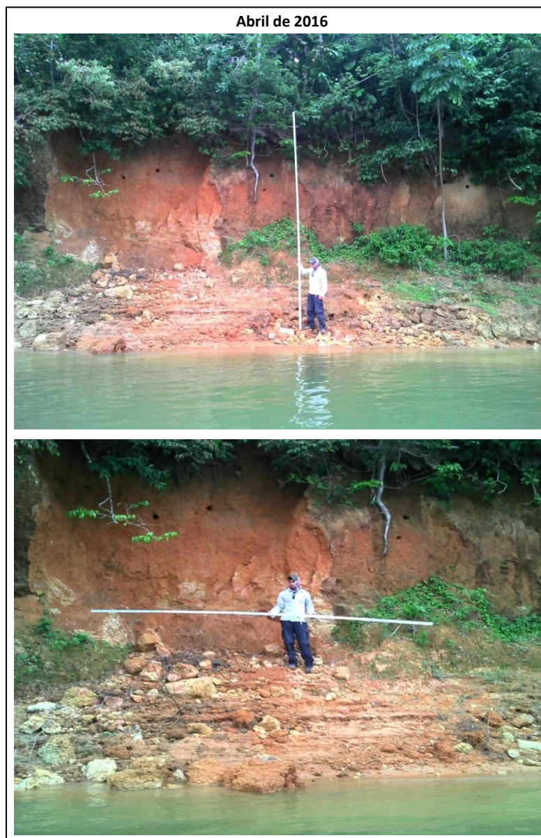
Figura 4. Vista ponto MD-03 na campanha de abril de 2016. Verificou-se que os processos erosivos estão estabilizados em quase toda a extensão do talude monitorado, sendo que na última campanha foi constatado movimento de massa em pequena porção do talude.
