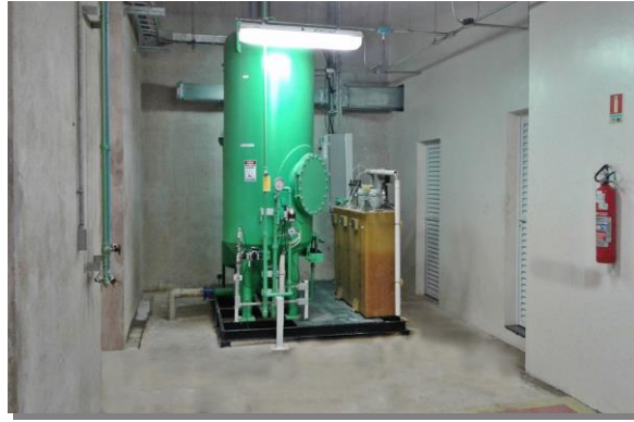
Figura 02. ETA – Casa de Força UHE Teles Pires.
